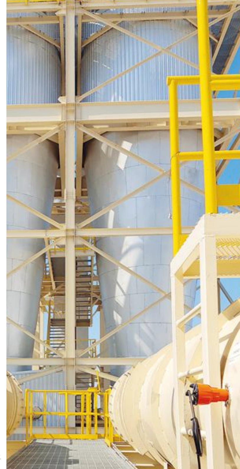
Fireflysystem installerat i utloppet från en MDF-tork i Thailand.
